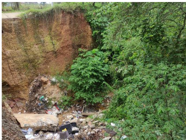
Zona de riesgo
