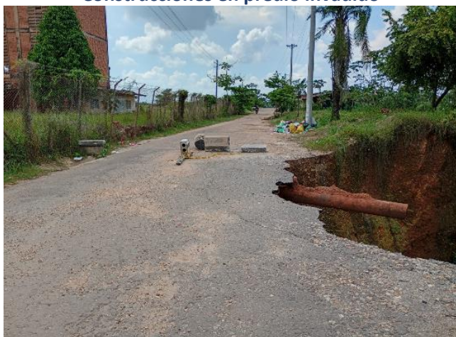
Vías de acceso con problemas
