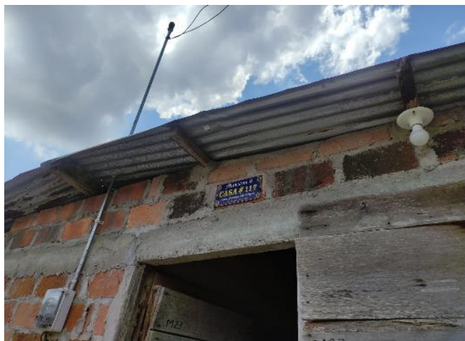
Construcción en franja invadida
