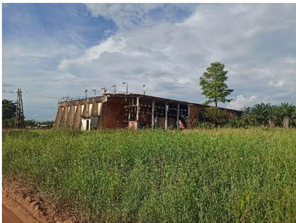
Planta de Agua
