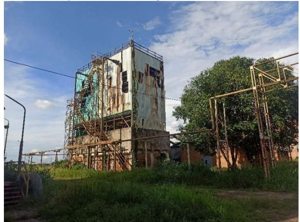
Torres de Enfriamiento
