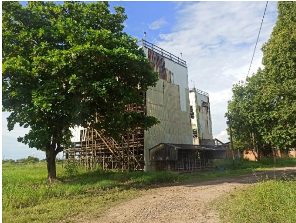
Torres de Enfriamiento
